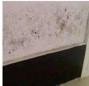
断熱性の悪い内装による結露
