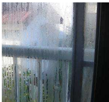
<施工前> 朝方 結露がひどい
