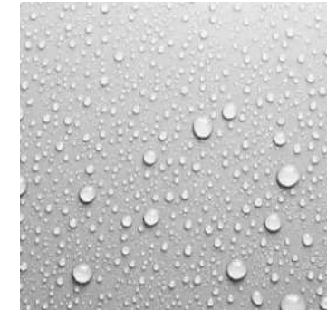
断熱性の悪い躯体による結露
